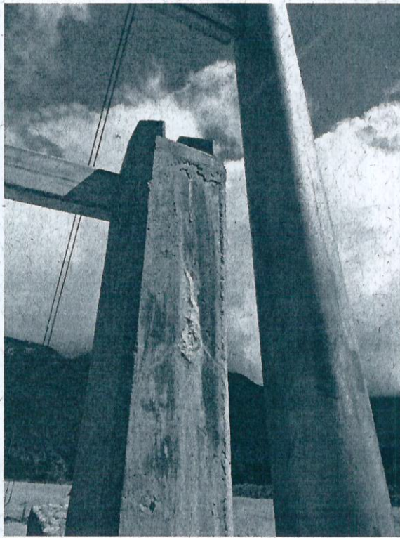
Fotografía N° 7 – 04/12/2017: Deficiencias en el acabado del hormigón.
