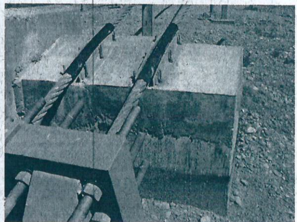
Fotografía N° 10 – 04/12/2017: Defectos en el acabado de elementos de hormigón.
