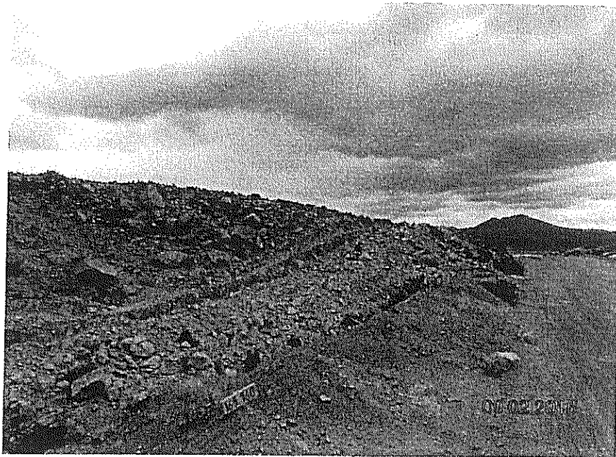
Fotografía N° 7, 2 de septiembre de 2015, foso revestidos no ejecutados en el km. 165,960
