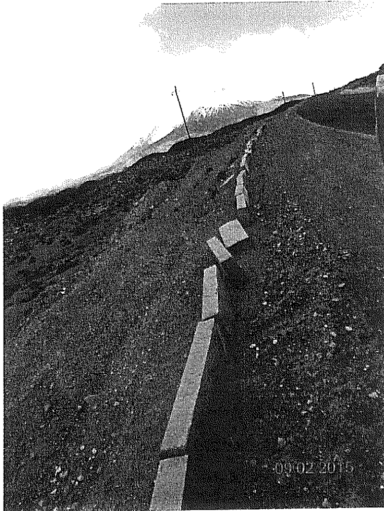
Fotografía N° 6, 2 de septiembre de 2015, soleras tipo "A" no instaladas en el km. 168,160.
