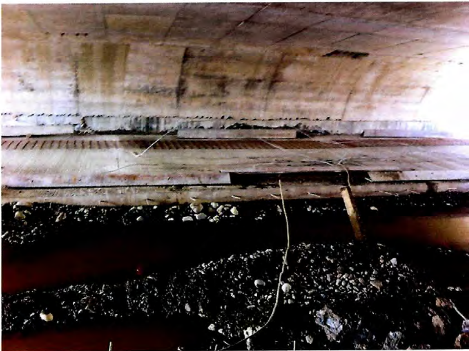
Foto N° 10: Falta ejecutar pavimento de hormigón de lecho del río.
