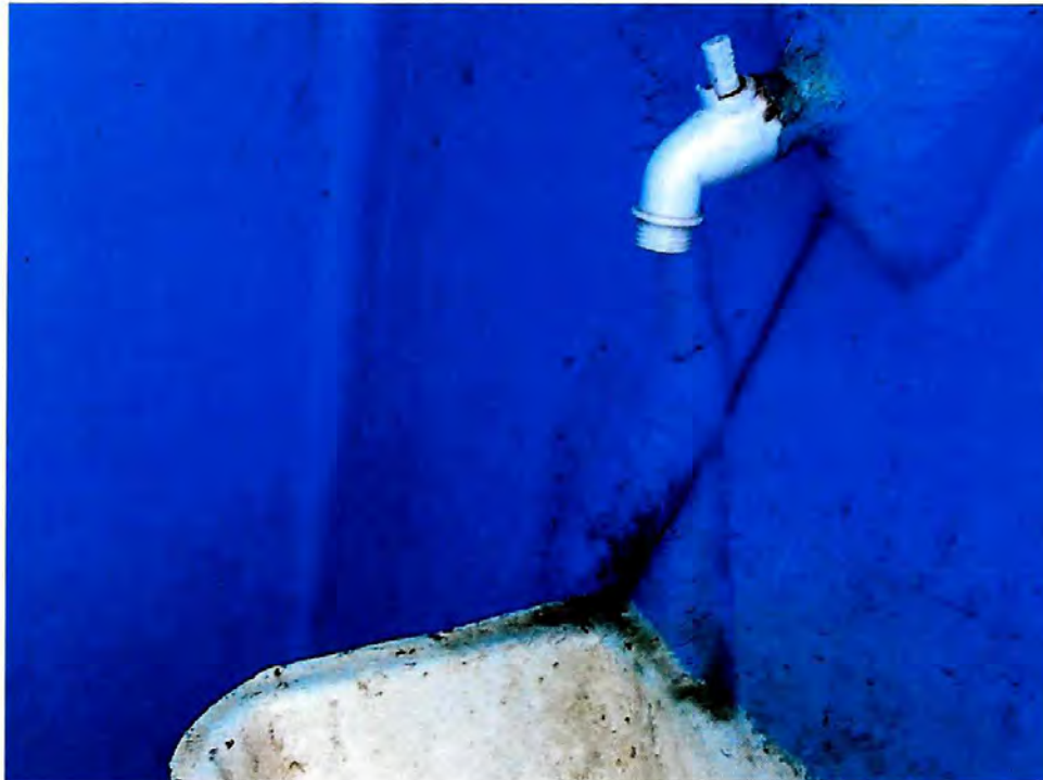
Foto N° 11: Falta implementar las condiciones sanitarias básicas.
