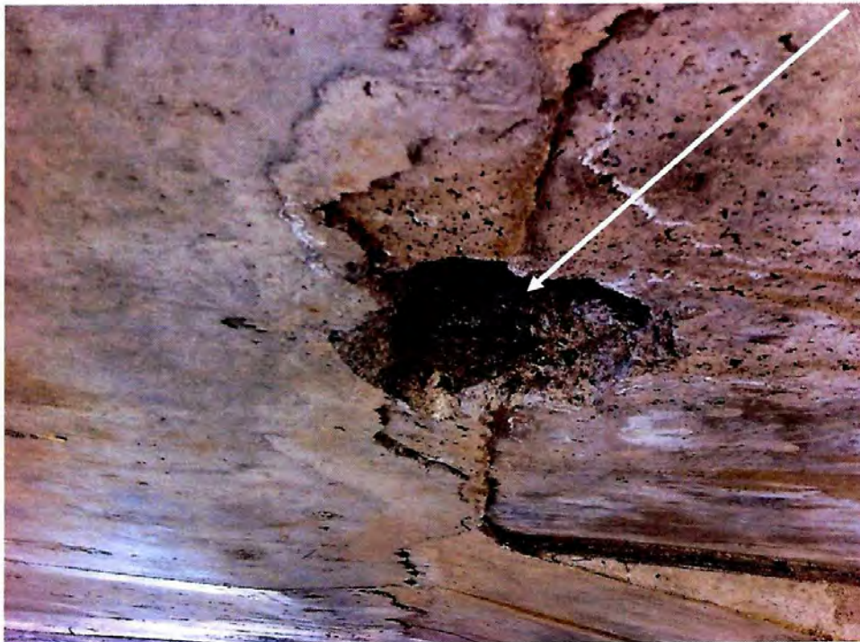
Foto N° 2: Cavidad bajo losa.
