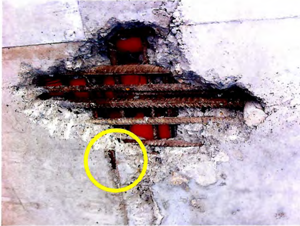
Foto N° 5: Armadura sin recubrimiento de hormigón.
