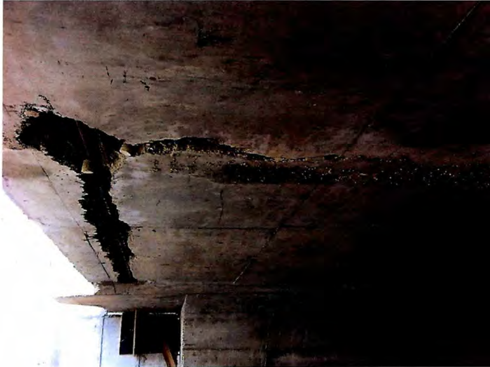
Foto N° 1: Oquedad bajo losa de hormigón puente con enfierradura a la vista.
