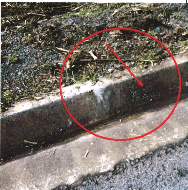
Fotografía N° 7: Solera con nido de piedras Km 6.660.
