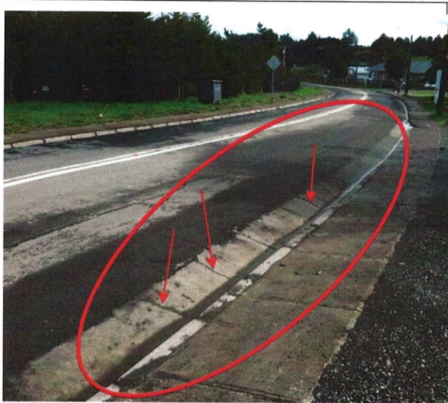
Fotografía N° 5: Grietas en superficie de cuneta Km 5.240.
