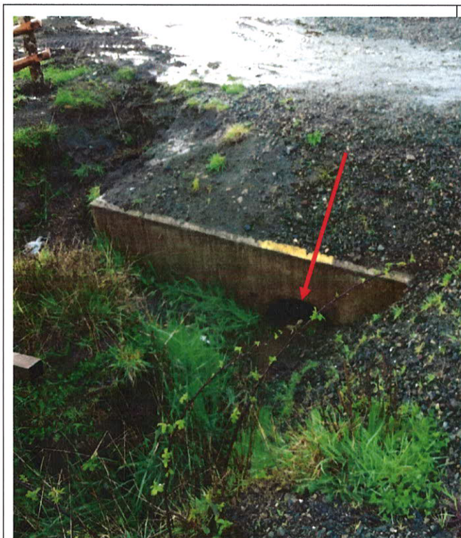
Fotografía N° 3: Obra de arte longitudinal embancada Km 3.820.
