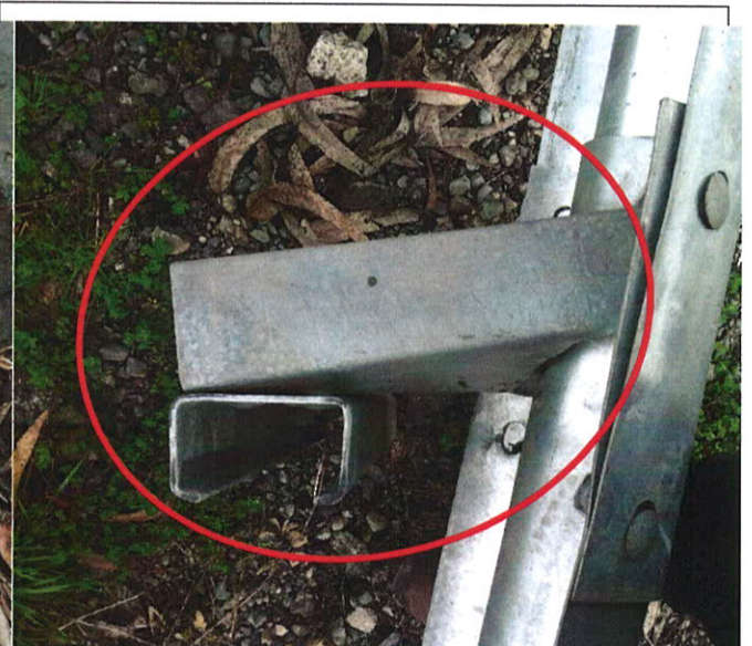
Fotografía N° 10: Barrera chocada Km 1.810
