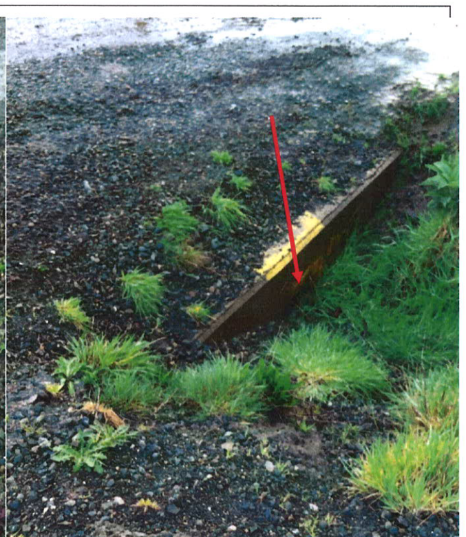
Fotografía N° 4: Obra de arte longitudinal embancada Km 3.820.
