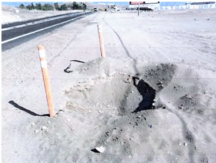
Fotografía 1: Excavaciones, Obra Inconclusa.
