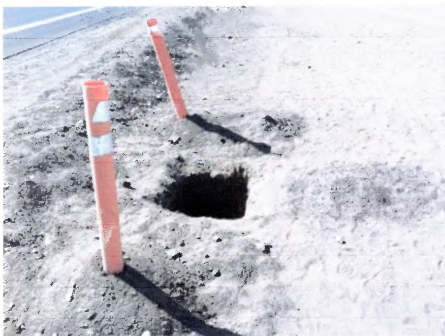
Fotografía 2: Excavaciones, Obra Inconclusa.
