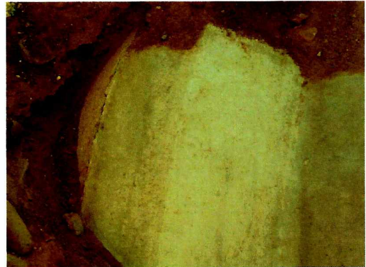
Fotografía N° 28: Junta mal sellada.
