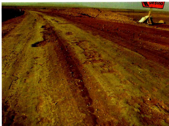
Fotografía N° 23: Desvío en mal estado.
