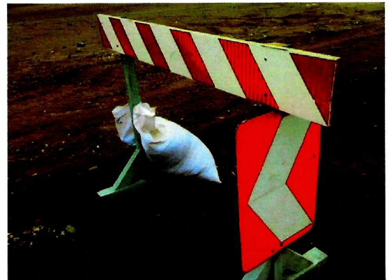
Fotografía N° 24: Barrera Tipo I.
