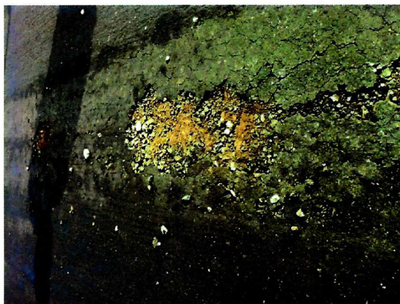
Fotografía N° 11: Bache de severidad baja
