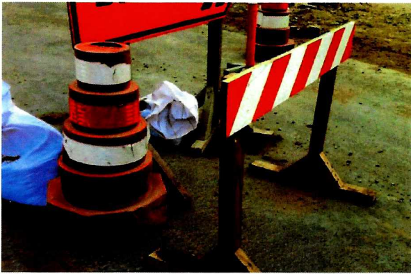
Fotografía N° 3: Barrera Tipo I.
