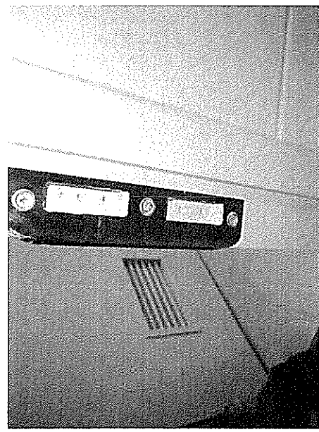
Fotografía N°11: Deficiente cierre de puerta baño universal norte del primer piso.
