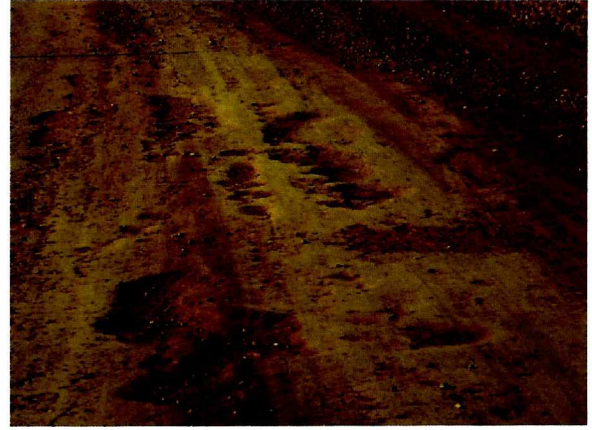
Fotografía N° 20: Camino existente con severos deterioros.
