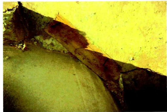
Fotografía N°30: Madera incorporada en boca de muro.
