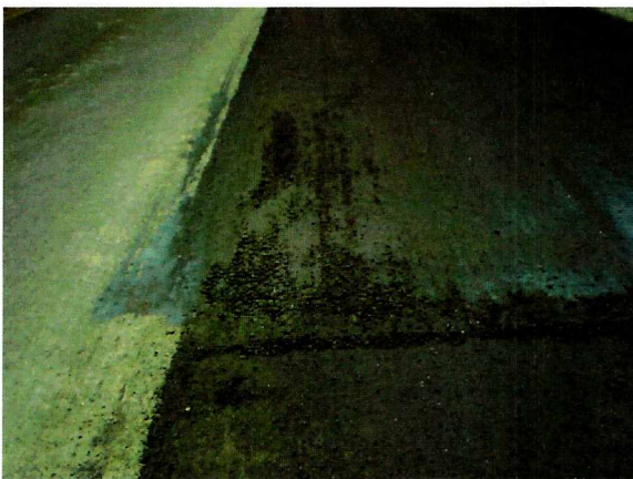
Fotografía N° 17: Defecto de terminación.
