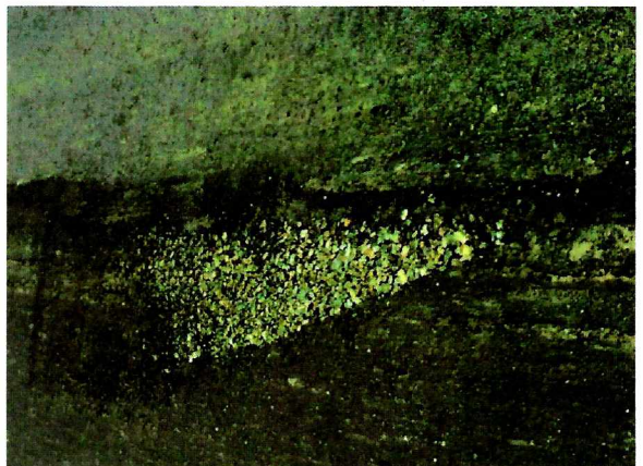
Fotografía N° 16: Defectos de terminación.
