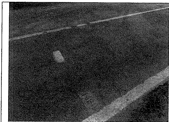
Fotografía N°31: Deterioro de demarcación línea central, cercano a kilómetro 14,9, camino rol G-27. (19-08-2013)
