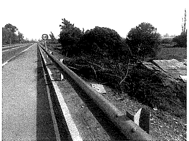
Fotografía N°18: Los fosos presentan vegetación y basura, kilómetros 0 a 1, camino rol 73A78. (20-08-2013)
