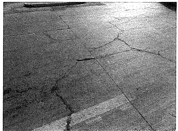
Fotografía N°14: Fisuras y grietas con sellos deteriorados, cercano a kilómetro 8,9, camino rol G-27. (19-08-2013)
