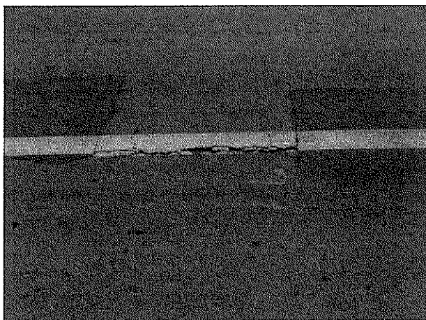
Fotografía N°27: Grietas con desprendimiento de material en línea central, cercano a kilómetro 13,8, camino rol G-27. (19-08-2013)
