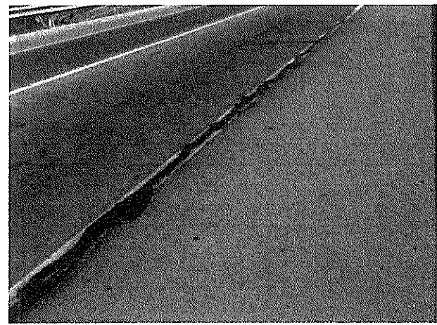
Fotografía N°15: Línea lateral derecha incompleta por sello en kilómetro 0,2, camino rol 73A78. (20-08-2013)
