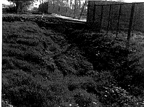
Fotografía N°26: Exceso de vegetación en foso, cercano a kilómetro 13,5, camino rol G-18. (20-08-2013)
