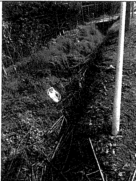
Fotografía N°35: Exceso de vegetación en foso izquierdo, kilómetro 18, camino rol G-18. (20-08-2013)
