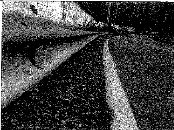
Fotografía N°35: Defensa caminera sin elementos reflectantes, cercano a kilómetro 16,8, camino rol G-27.
