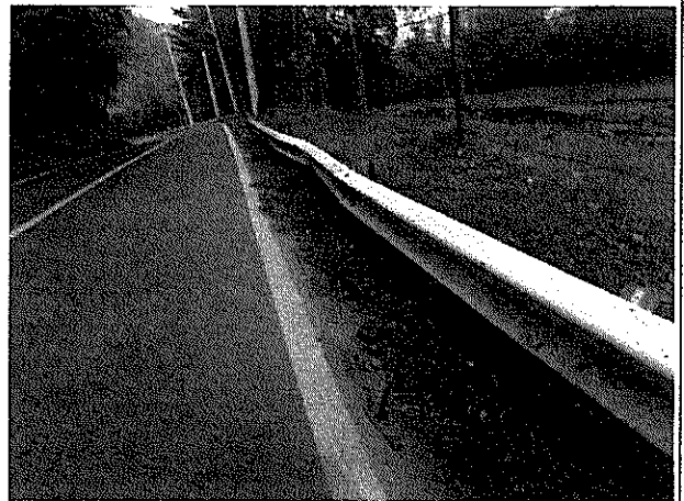
Fotografía N°46: Defensa dañada, cercano a kilómetro 17,8, camino rol G-27. (19-08-2013)
