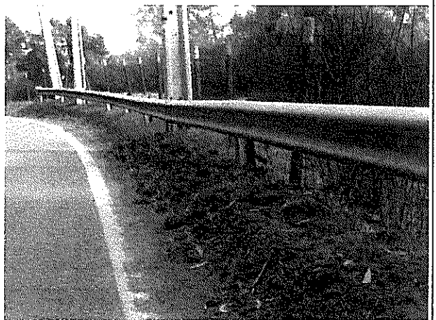
Fotografía N°54: Defensa caminera sin elementos reflectantes, cercano a kilómetro 18, camino rol G-27. (19-08-2013)
