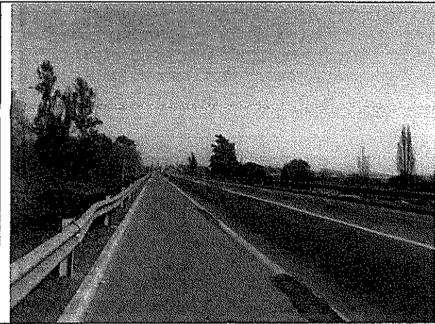
Fotografía N°13: Defensa caminera en mal estado, kilómetro 0,2, camino rol 73A78. (20-08-2013)
