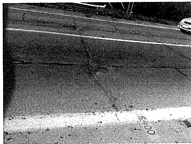
Fotografía N°26: Calzada de asfalto con grietas, kilómetro 5,4, camino rol G-40. (21-08-2013)
