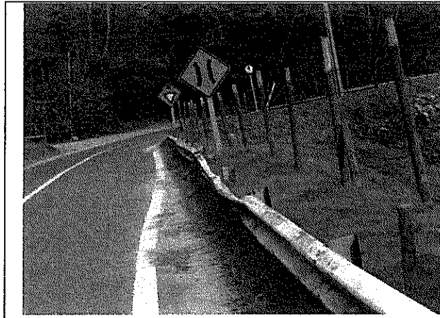
Fotografía N°49: Defensa caminera dañada, cercano a kilómetro 17,8, camino rol G-27. (19-08-2013)
