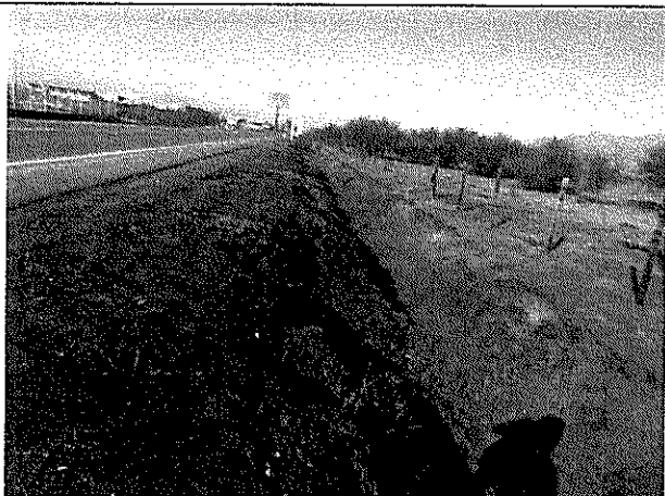
Fotografía N°31: Exceso de vegetación en foso izquierdo, kilómetro 15, camino rol G-18. (20-08-2013)
