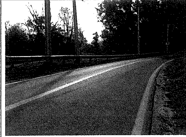
Fotografía N°13: Ruta .G-27, cercano a 18,1 km. (19-08-2013)
