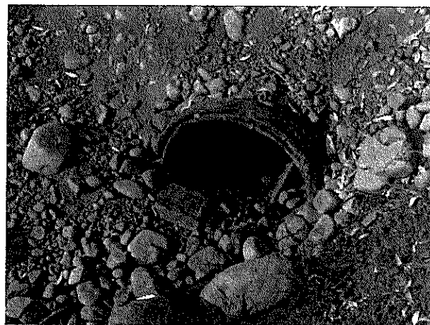
Fotografía N°28: Alcantarilla sin su sección libre en un 90%, cercano a kilómetro 13,5, camino rol G-18. (20-08-2013)
