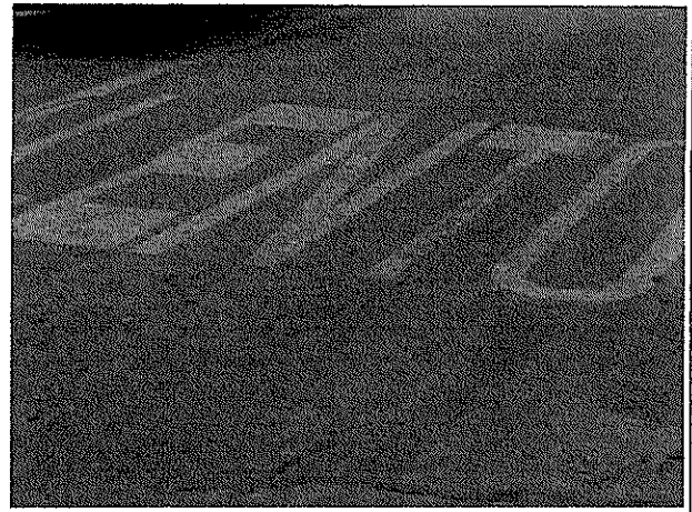
Fotografía N°20: Demarcación "LENTO" deteriorada, poco visible, cercano a kilómetro 8,9, camino rol G-27. (19-08-2013)
