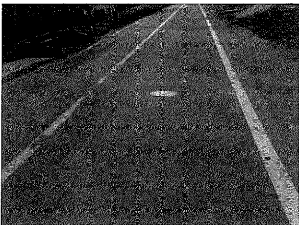
Fotografía N°23: Deterioro de demarcación línea central, cercano a kilómetro 13,5, camino rol G-27. (19-08-2013)
