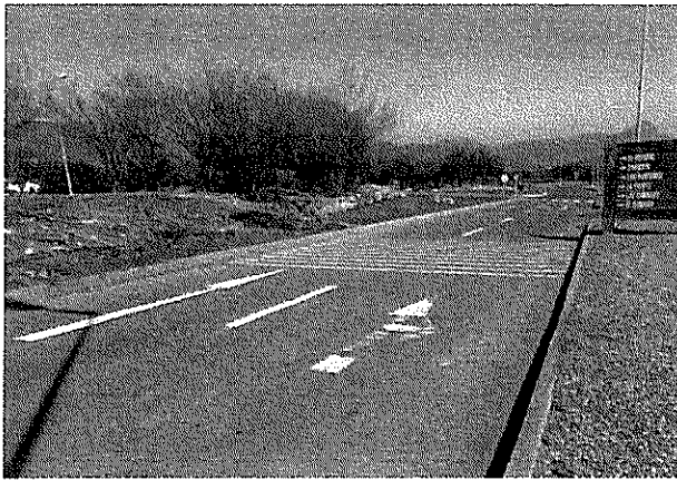
Fotografía N°43: Demarcación de flecha deteriorada, cercano a kilómetro 8, camino rol G-19, calzada descendente. (09-08-2013)
