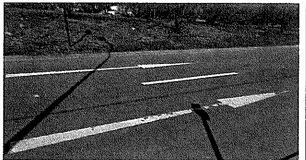
Fotografía N°42: Demarcación de flecha deteriorada, cercano a kilómetro 8, camino rol G-19, calzada descendente. (09-08-2013)
