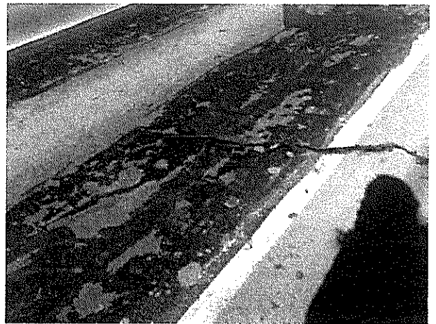
Fotografía N°22: Tratamiento de grietas deficiente, entre kilómetros 20 a 21, camino rol G-30. (14-08-2013)
