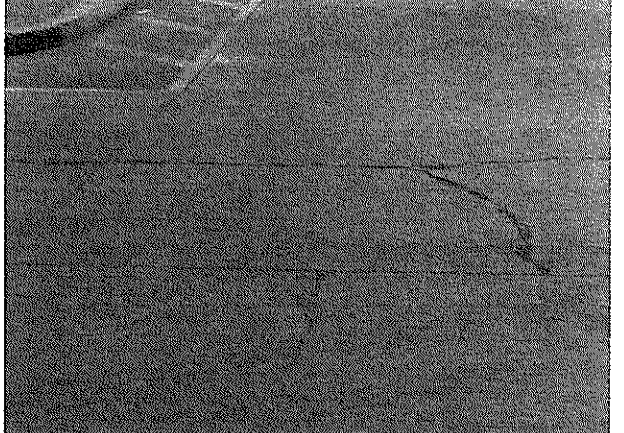
Fotografía N°16: Fisuras y grietas con sellos deteriorados, cercano a kilómetro 8,9, camino rol G-27. (19-08-2013)
