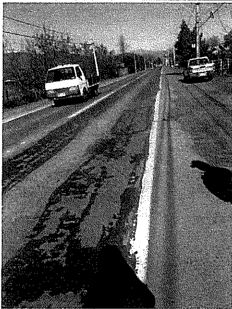
Fotografía N°21: Tratamiento de grietas deficiente, entre kilómetros 20 a 21, camino rol G-30. (14-08-2013)
