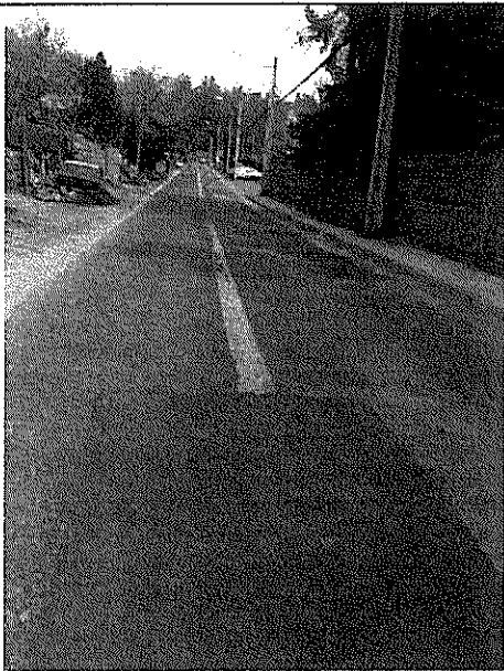
Fotografía N°25: Ausencia y deterioro de demarcación línea central, cercano a kilómetro 13,5, camino rol G-27. (19-08-2013)
