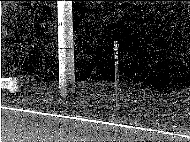
Fotografía N°51: Detalle hito vertical sin placa, cercano a kilómetro 18, camino rol G-27. (19-08-2013)
