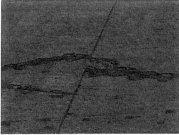
Fotografía N°13: Detalle de fisuras y grietas con sellos deteriorados (foto N°14), cercano a kilómetro 8,9, camino rol G-27. (19-08-2013)
