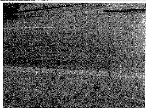
Fotografía N°12: Fisuras y grietas con sellos deteriorados, cercano a kilómetro 8,9, camino rol G-27. (19-08-2013)
