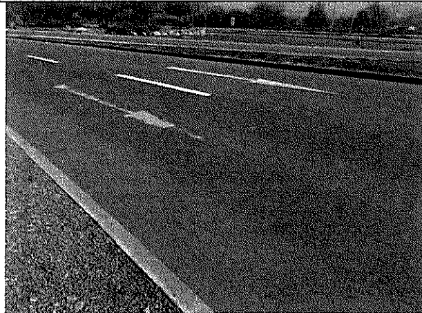
Fotografía N°39: Demarcación de flecha deteriorada, cercano a kilómetro 8, camino rol G-19, calzada ascendente. (09-08-2013)
