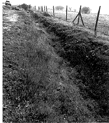
Fotografía N°22: Exceso de vegetación en foso, kilómetro 12, camino rol G-18. (20-08-2013)
