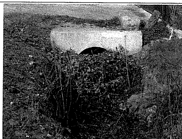
Fotografía N°32: Alcantarilla sin su sección libre en un 90%, kilómetro 15, camino rol G-18. (20-08-2013)
