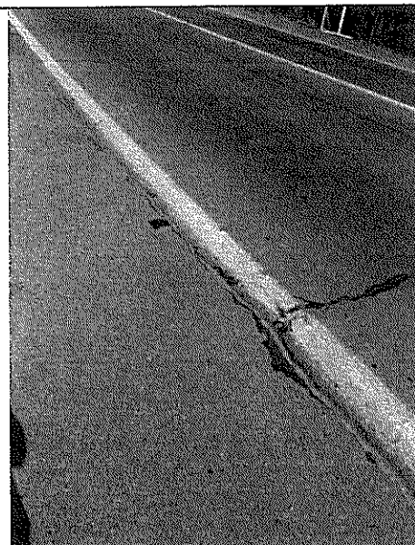
Fotografía N°28: Calzada de asfalto con sellos discontinuos, kilómetro 5,8, camino rol G-40. (21-08-2013)
