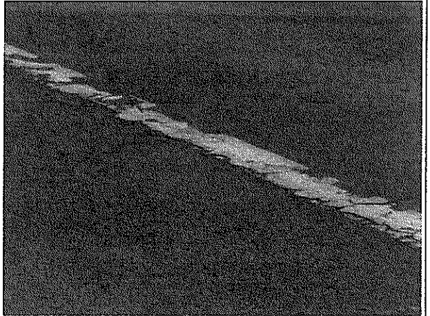
Fotografía N°24: Deterioro de demarcación línea central, cercano a kilómetro 13,5, camino rol G-27. (19-08-2013)
