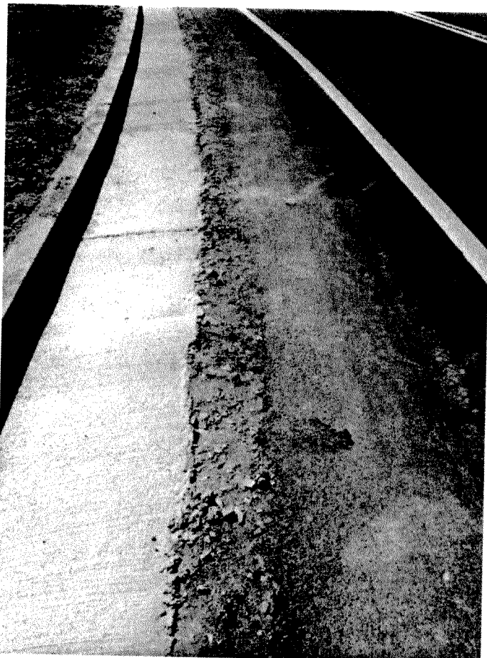
Fotografía N° 1. Zarpas sin juntas longitudinales al pavimento, Ruta 1, km 13,1.
