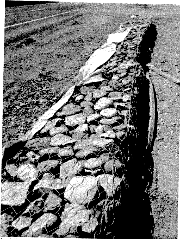
Fotografía N° 4. Gaviones con deformaciones en Ruta 1, km 15,2
