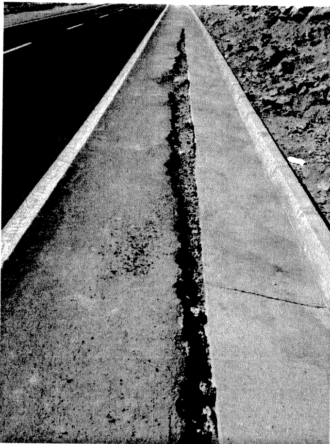
Fotografía N° 2. Zarpas sin juntas longitudinales al pavimento en Ruta 1, km 13,7.
