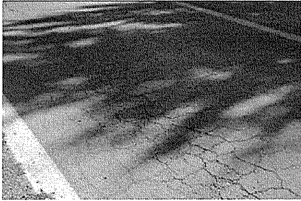
Fotografía N° 7: Detalle Fisuras y grietas en pavimento.
